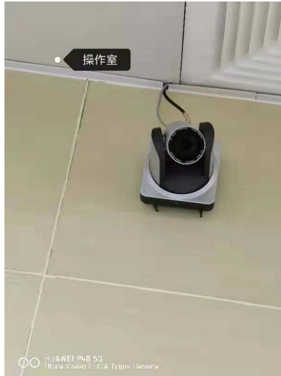
机房内监控装置
