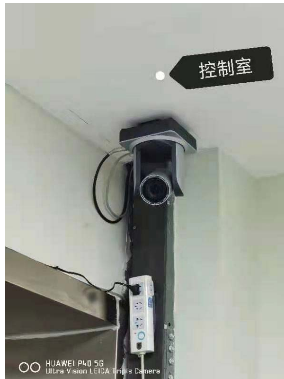
控制室监控装置
