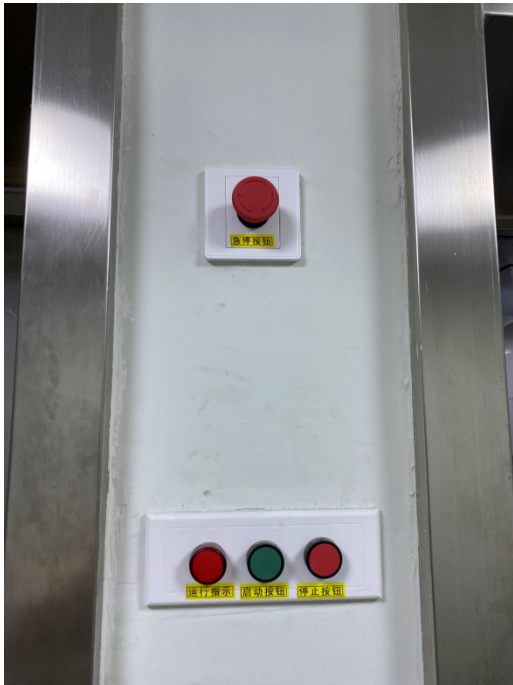
控制室急停按钮
